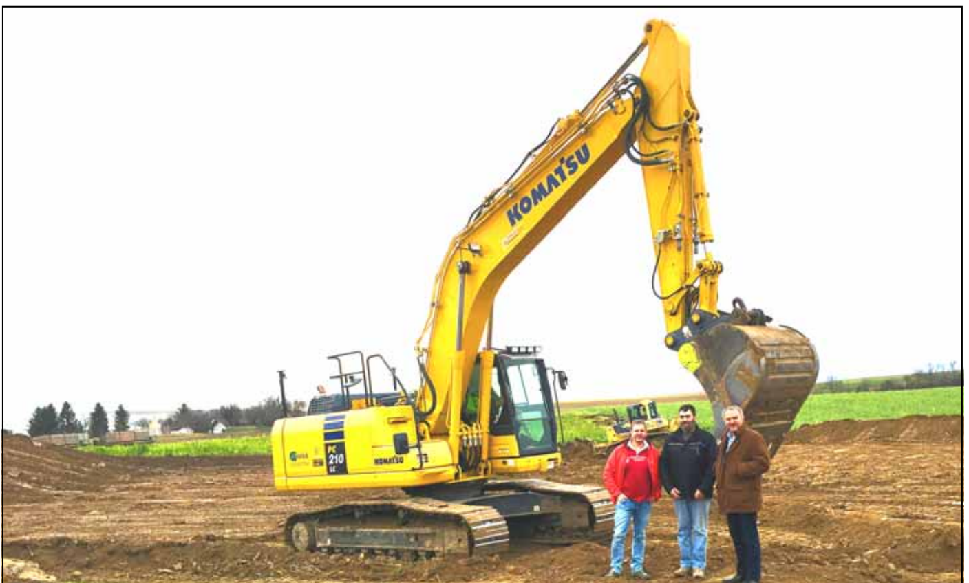
Rückhaltebecken Herzogbirbaum (Vbgm. Johannes Weinhappl, Ortsvorsteher Franz Sigl, Bgm. Karl Lehner)
